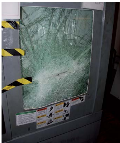
Att denna behöver bytas förstår alla.
